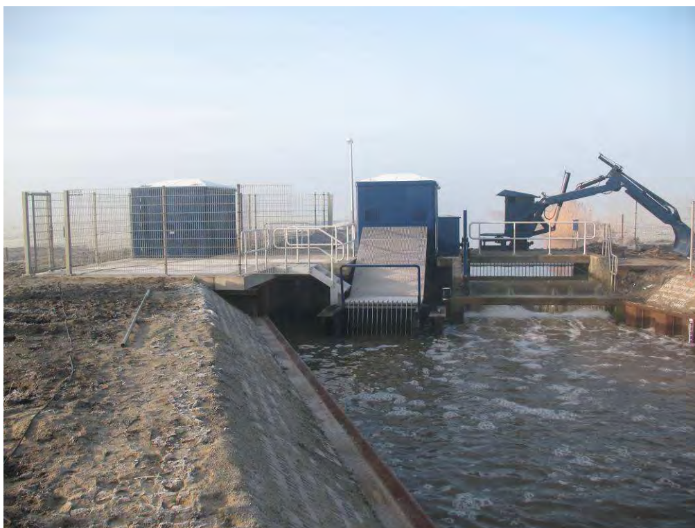
Figuur 2.1 Aan- en afvoer van water vindt plaats via het gemaal Kerkeland bij het Amsterdam Rijnkanaal. De constructie links op de foto is de in het najaar van 2009 geplaatste vispassage.
