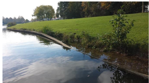
Een deel van de beschoeiing is verzakt en dient vernieuwd te worden.
